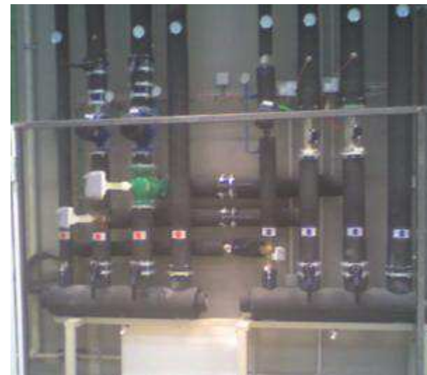
Obwody wtórne, kolektory hydrauliczne
